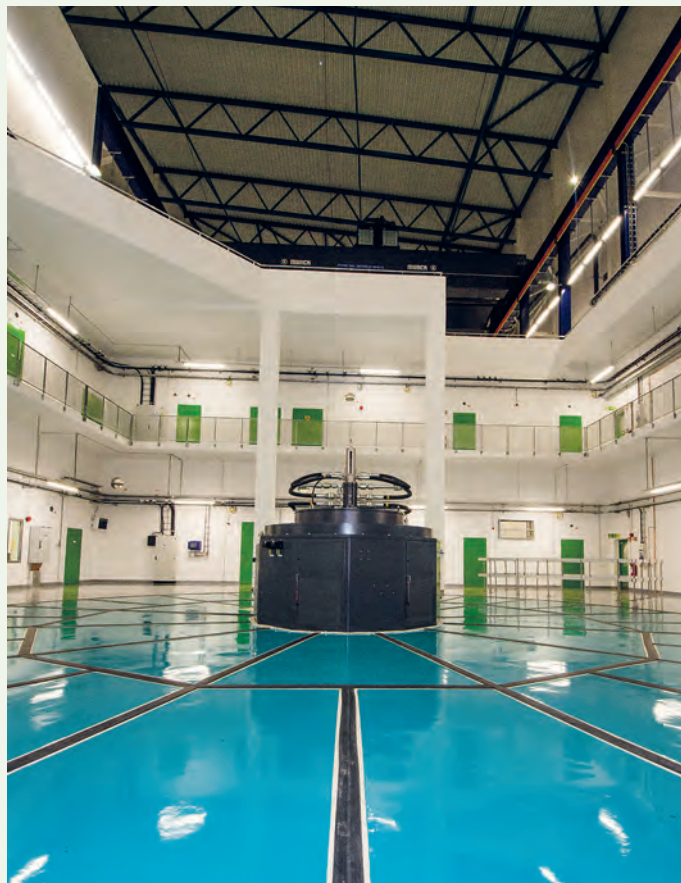
Turbintoppen er omkranset av to etasjer med mindre rom for tekniske støttesystemer.
